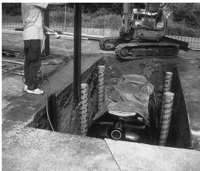
合併浄化槽で下水道整備が進む
