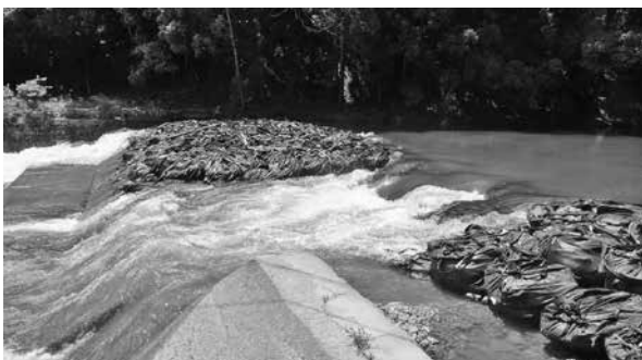
早期復旧を！ 甲田町上甲立 加屋頭首工
