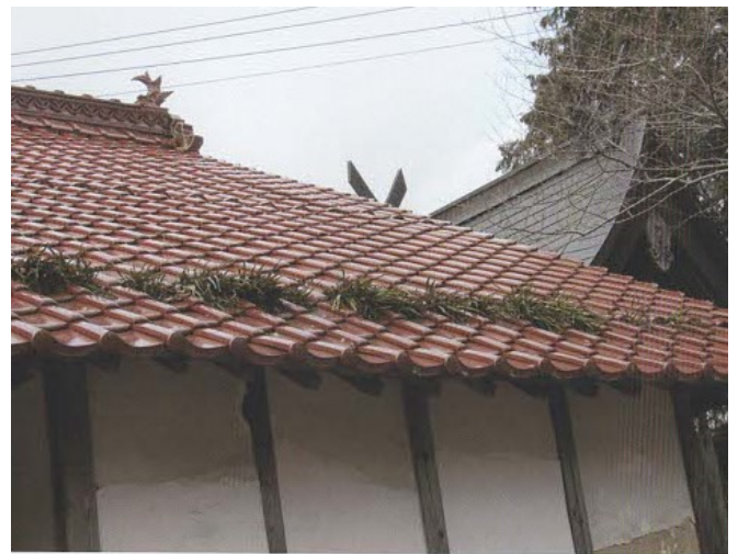
雪止め用瓦の所の草が生えている状況
