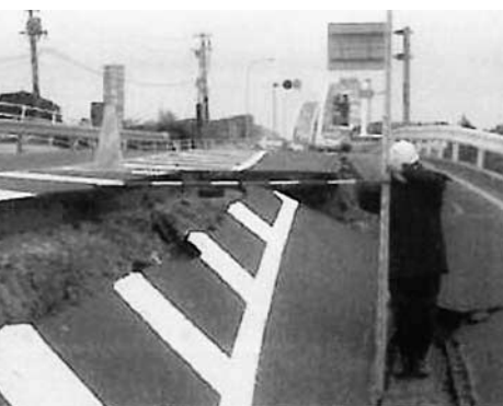
被災状況調査（石巻市国道45号）
