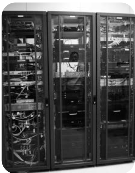
電算システム（サーバー）
