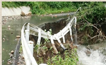
流水により崩れたガードレール
