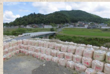
土のうでの仮復旧済 河川護岸の更なる欠壊防止
