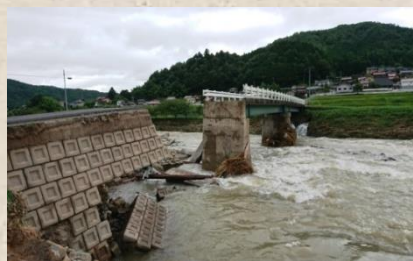
川の増水により壊れた道
