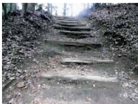
登山道の段木の腐食や土砂の流出
