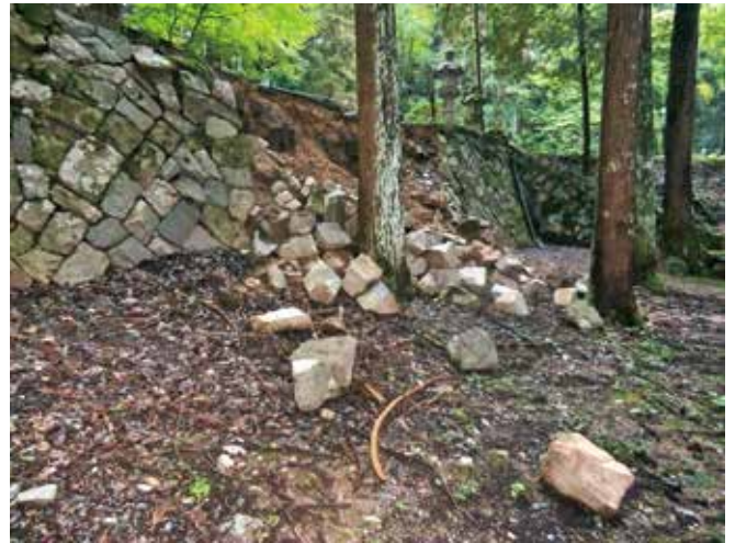
毛利元就墓所石垣崩落 (平成23年)
