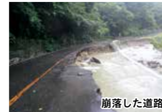
崩落した道路
