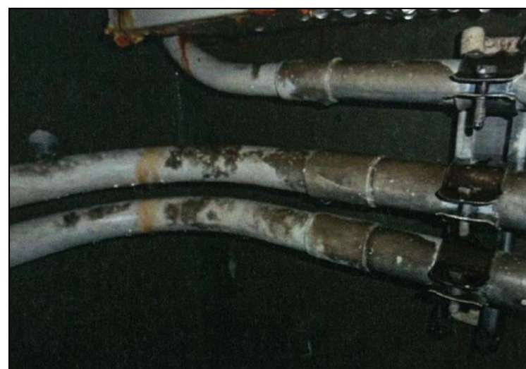
向原浄化センター 電気配管 (H6)
