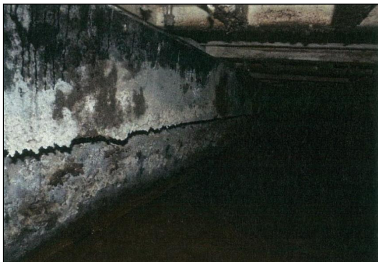
向原浄化センター 接触曝気槽内部 (H6)
