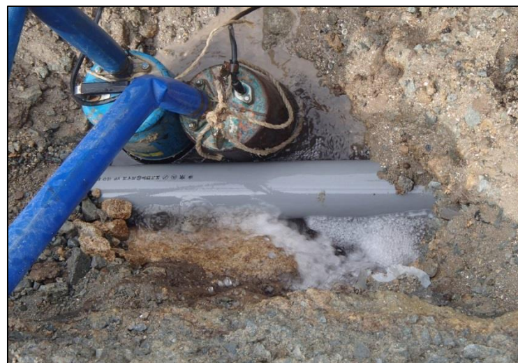
管路からの漏水
