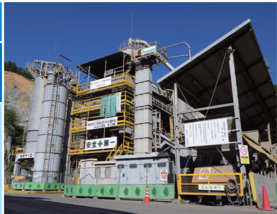
■アスファルトプラント
