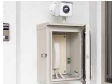
緊急時の通報に備えた電話「駆け込み通報装置」。
