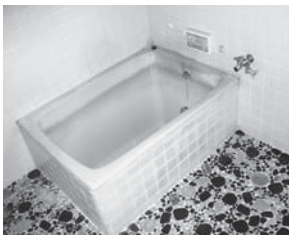
廊下は傷み、お風呂も狭い。全体的に古い印象。
