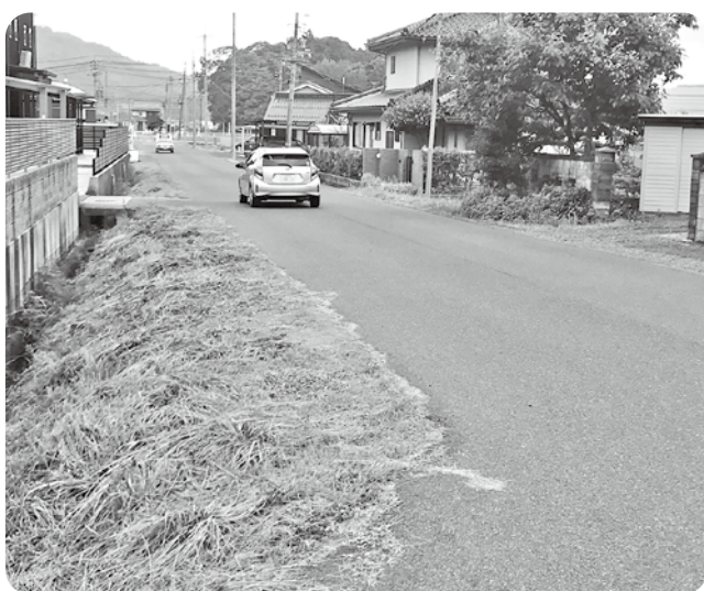
市道・法面の早急な整備を（一本木・川本線 通学路）
