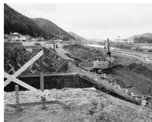
約4万㎡の河岸が削り取られて、川幅は約15m広がる
